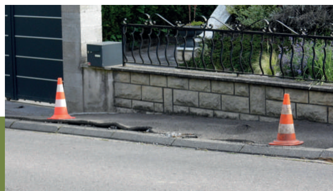
Soulèvement du trottoir rue Principale.
